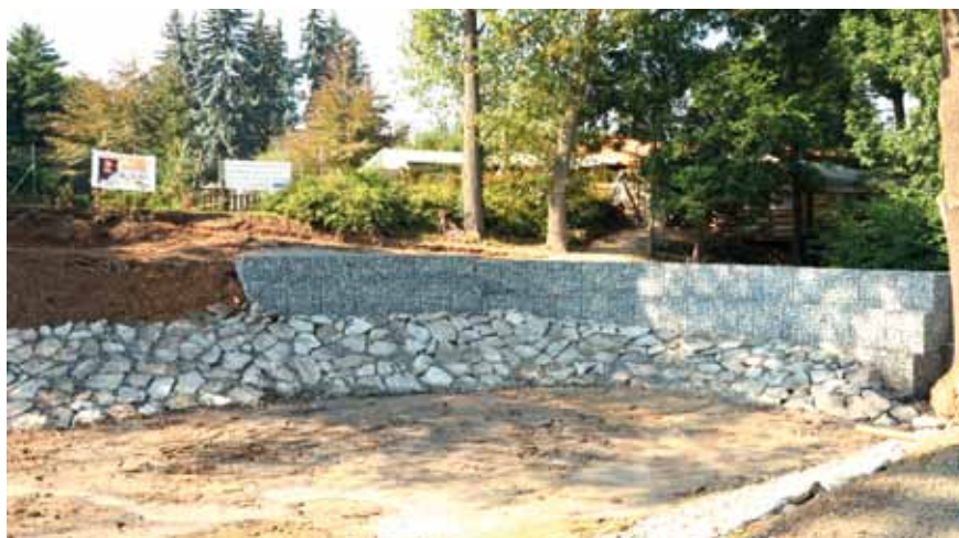
Gabionová stěna je vysoká čtyři metry a slouží jako opěrný svah pro cyklostezku
